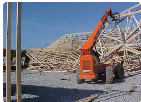
پیش از ریزش (بالا) و پس از ریزش (پایین) سقف در پروژه عمرانی
