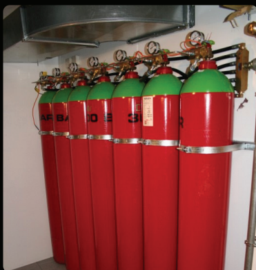
برخی تجهیزات پیشگیری و اطفای حریق دستی و هوشمند
